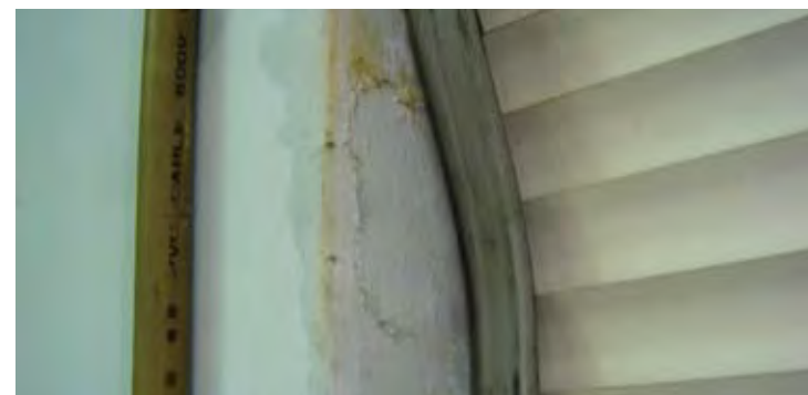
注意牆角、窗框的牆面，是否有水漬
